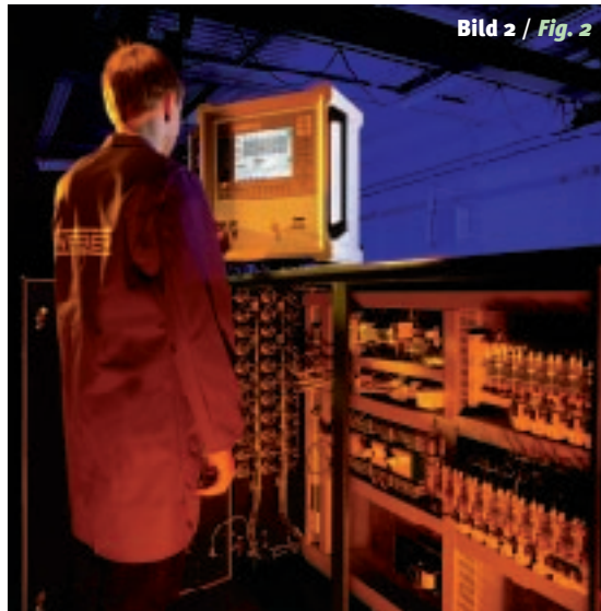
Bild 2: Bedienterminal IQT und die kompakt montierten Automatisierungskomponenten einer Weber Extrusionsanlage Fig. 2: IQT operating terminal and the closely mounted automation components of a Weber extrusion plant (Foto Weber, Kronach / PMA, Kassel)
